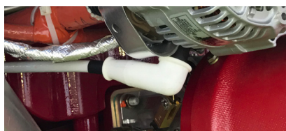
Photo 2 - Capuchon de protection (ici en blanc) sur la cosse d'un alternateur.
